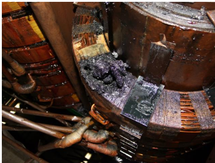
Obr. 11. Časť vinutia primárnej cievky poškodenej medzizávitovým skratom.
